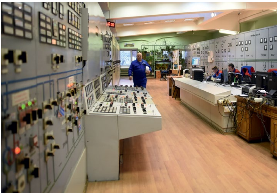
Щит управления ТЭЦ-9, 2018 год
