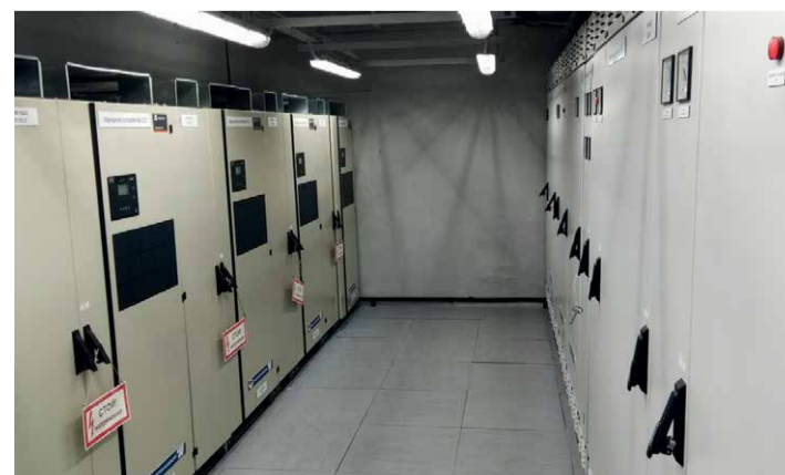
Щит постоянного тока № 1 ТЭЦ-12
