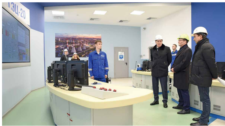
Алексей Алёшин, Павел Шацкий и Сергей Ленёв на блочном щите управления ПГУ-420 ТЭЦ-20
