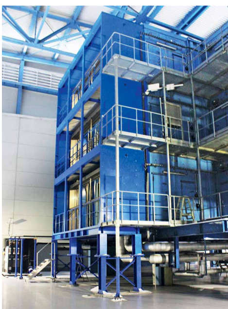
Надстройка КВОУ охладителем воздуха со вспомогательным оборудованием
