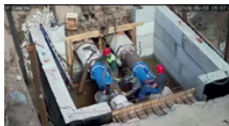
Видео с места проведения работ на РТС «Фрезер» можно было посмотреть в режиме реального времени с обычного смартфона
