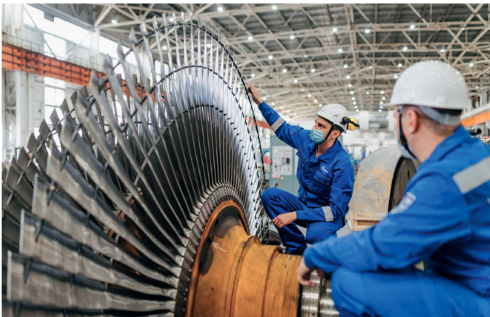
Все работы на оборудовании ТЭЦ и котельных ведутся с соблюдением комплекса мер охраны здоровья и безопасности персонала
