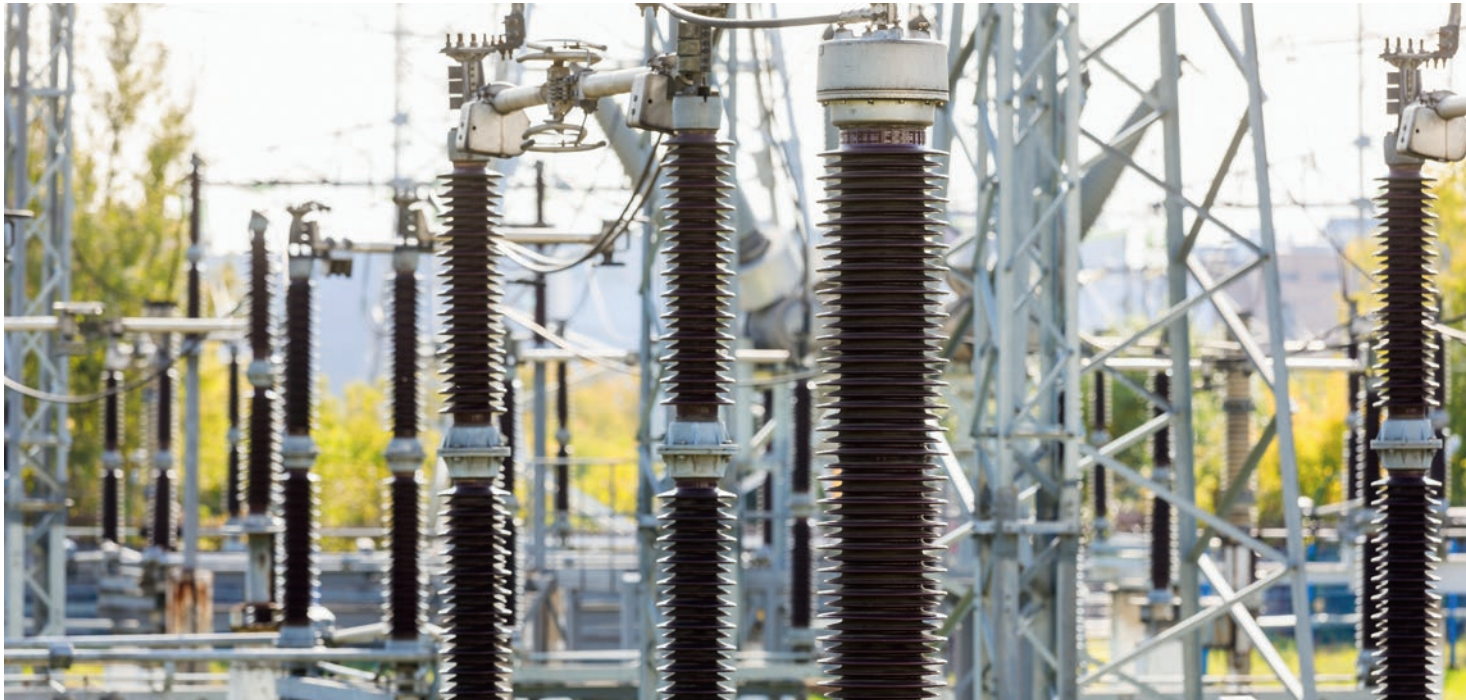
Оснащение распределительных устройств системами автоматического обнаружения перегрева позволит своевременно выявить дефекты, обеспечить надежность и безопасность эксплуатации электроустановок
