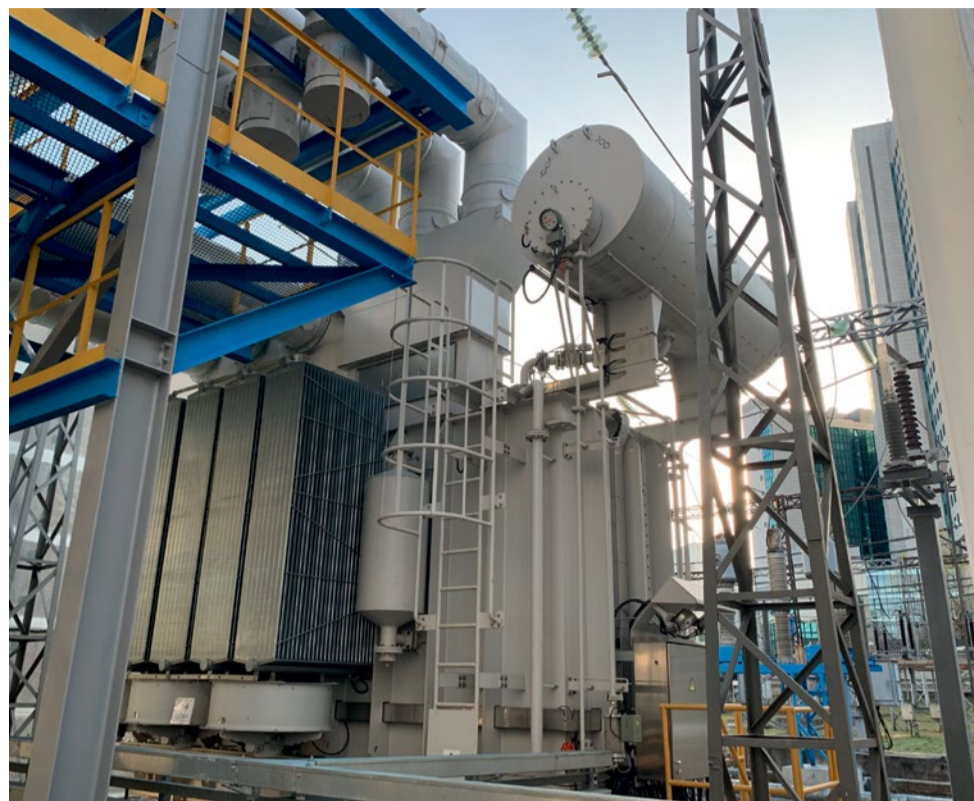
Трансформатор связи Т-3 ТЭЦ-20
