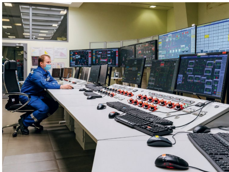
На щите управления ТЭЦ-23, 2020 год
