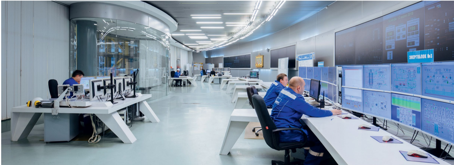
Контроль и управление процессами энергоблоков № 3 и № 4 осуществляется с единого центрального щита управления
