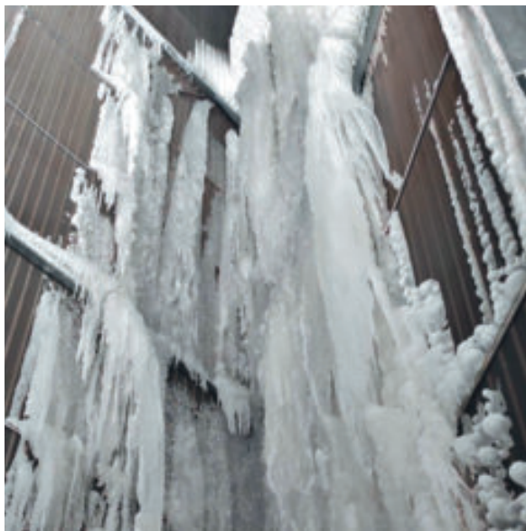
Рис. 24. Нарушение плотности трубной системы СВГ в результате образования ледяных пробок
