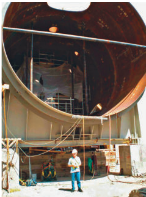
Рис. 14. Фотография паропровода ВКУ электростанции Comanche мощностью 829 МВт (г. Пуэбло, шт. Колорадо, США)
