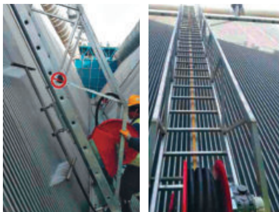
Рис. 25. Устройство автоматической очистки теплообменной поверхности ВКУ фирмы SPIG (две проекции)
