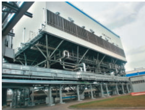
Рис. 13. Сухая вентиляторная градирня фирмы SPIG, установленная на ТЭЦ-12 Мосэнерго
