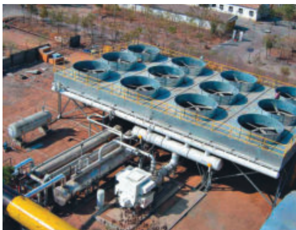
Рис. 33. Компоновка ВКУ мощностью 4 МВт
