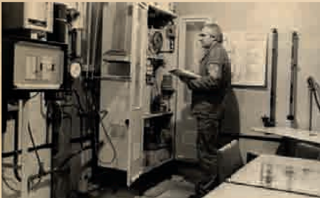
Калориметрическая установка ТЭЦ-26, 1989 год
