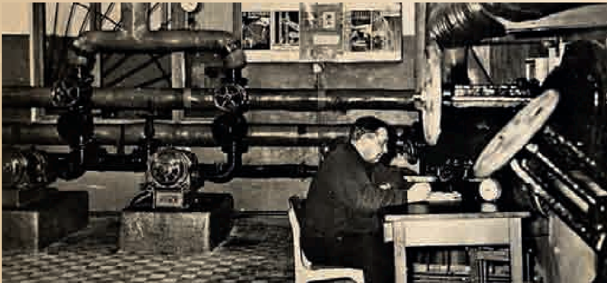
ЦТП-2 Беляево – Богородское, 8-й район Теплосети Мосэнерго, 1960-е годы
