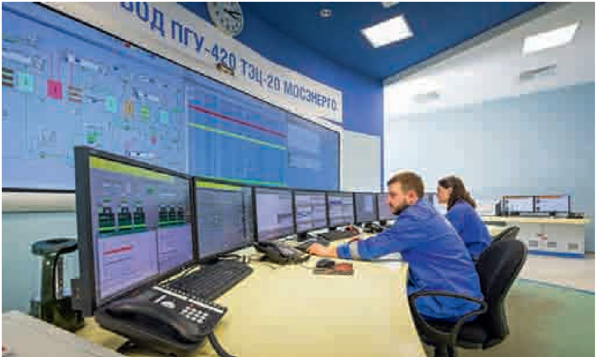
Щит управления энергоблока ПГУ-420 ТЭЦ-20, 2017 год
