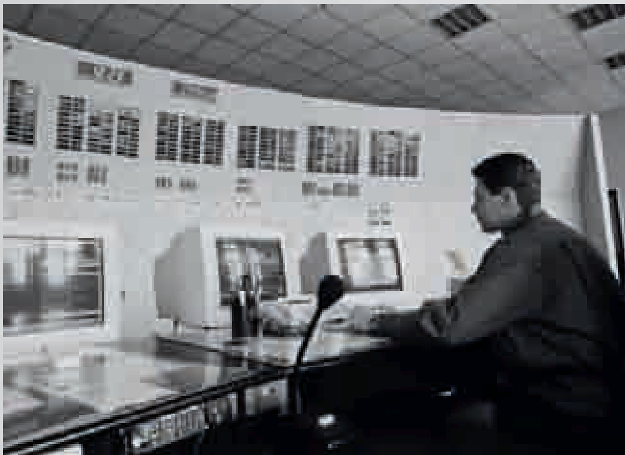
На щите управления ТЭЦ-27, 1990-е годы
