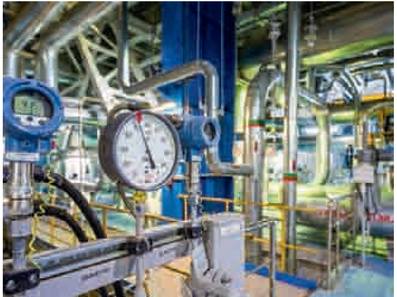
Оборудование машинного зала ТЭЦ-20
