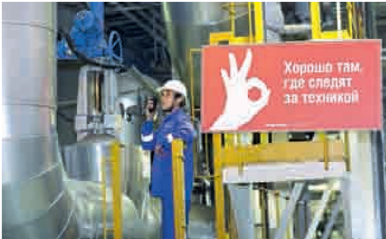
В машинном зале ТЭЦ-26
