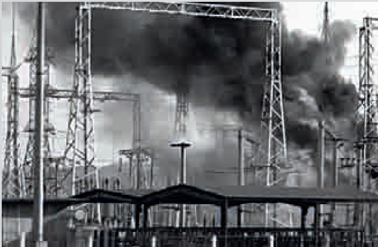
Пожар на подстанции «Чагино», май 2005 года
