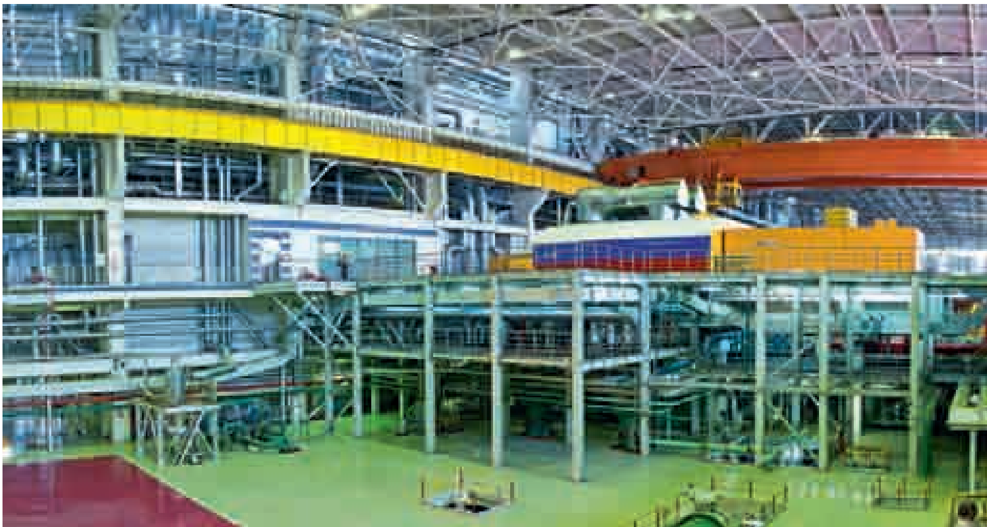
Машинный зал ПГУ-425 ТЭЦ-21
