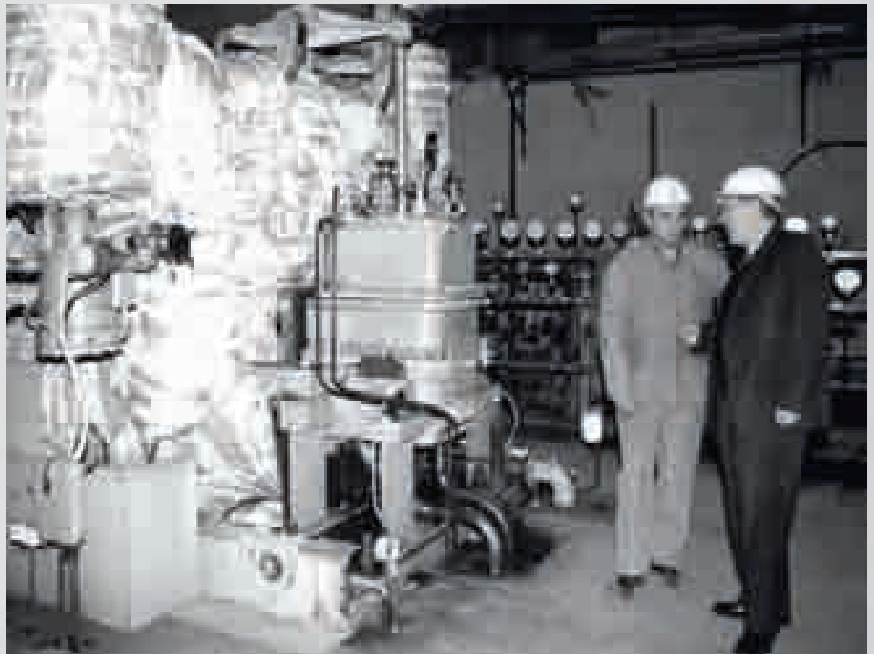
В конце 1990-х годов на ГЭС-1 им. П.Г. Смидовича была введена турбина Р-25К-3, заменившая работавший со времен войны немецкий агрегат
