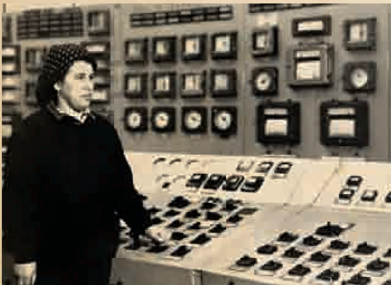
ТЭЦ-21, щит управления, 1980-е годы
