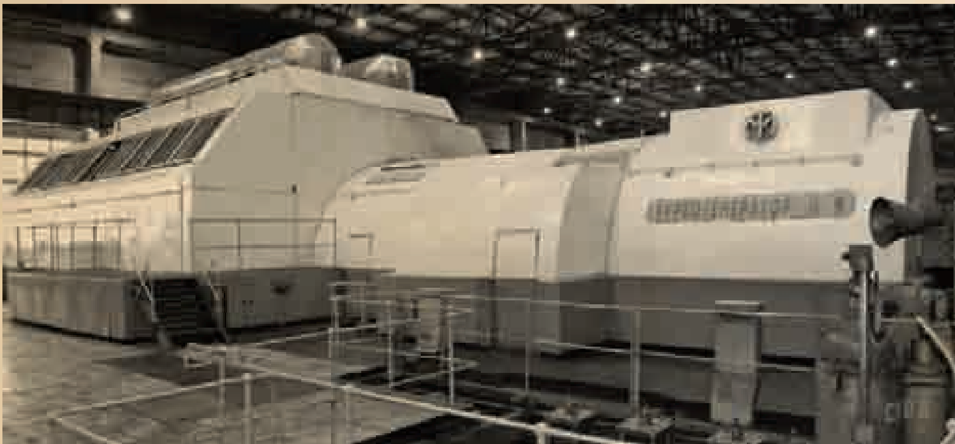
Головной теплофикационный блок с турбиной Т-250-240, введенный в 1972 году на ТЭЦ-22
