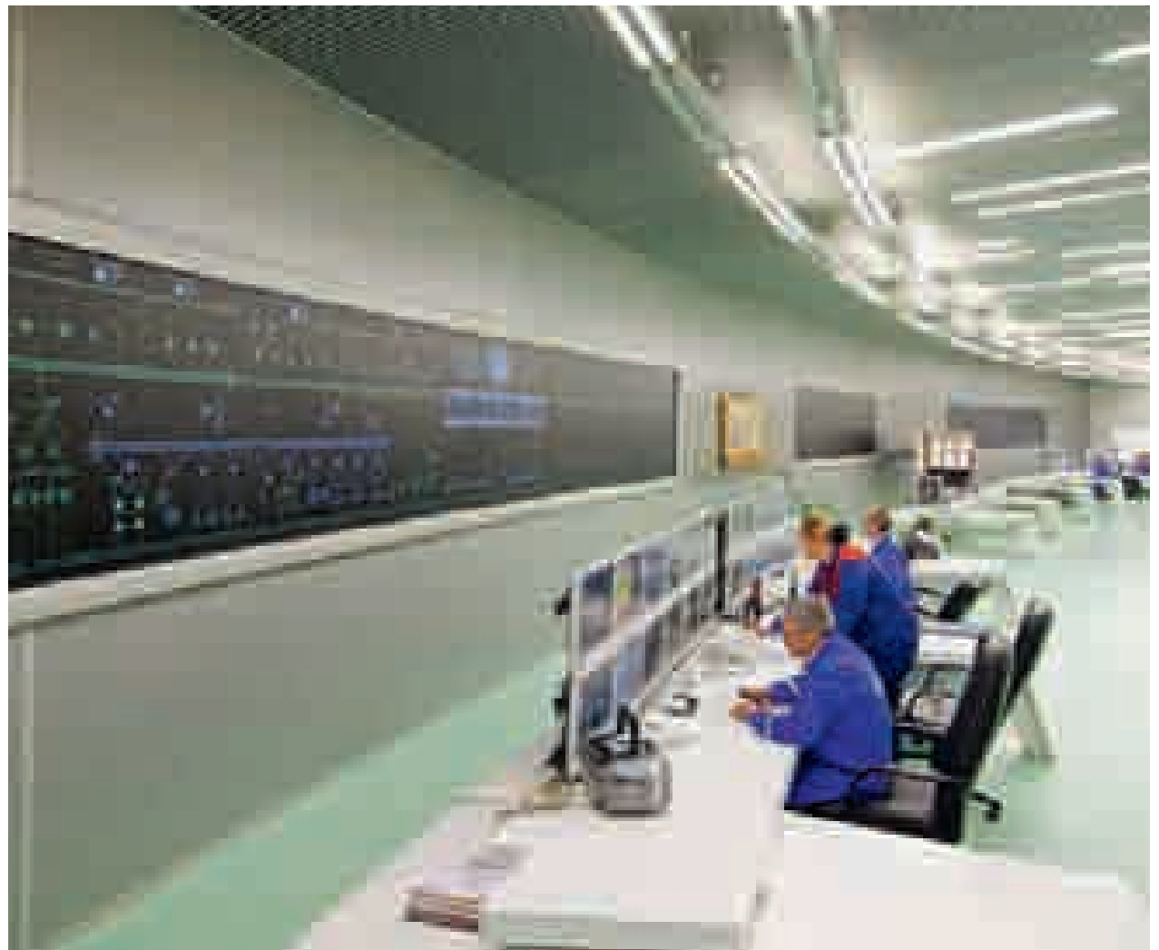
Щит управления двух парогазовых энергоблоков ТЭЦ-27
