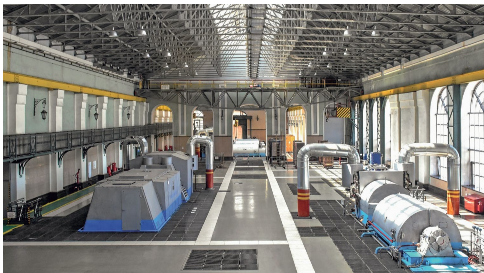
Машинный зал ГЭС-1, 2021 год
