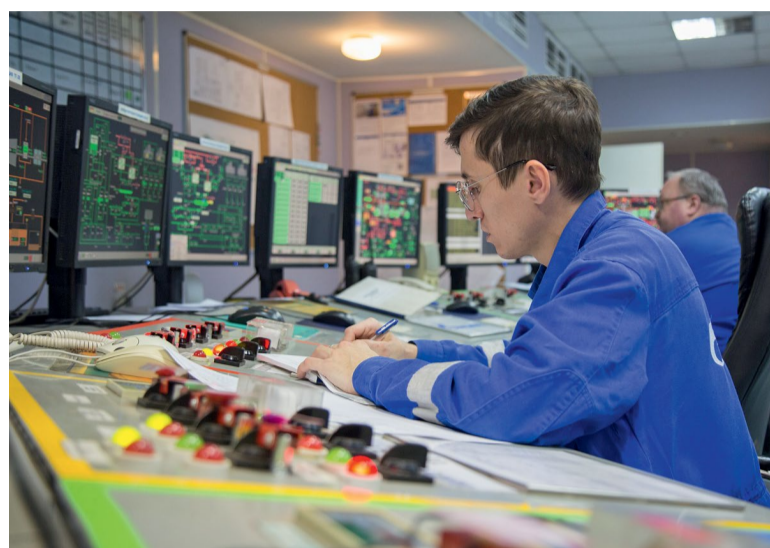
На центральном тепловом щите управления ГЭС-1, 2022 год
