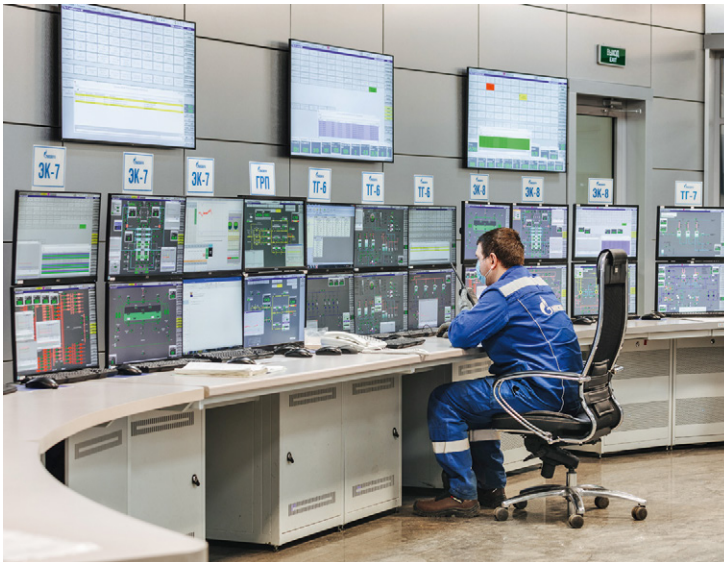
Реконструированный БЩУ котлами и турбинами № 5–7
