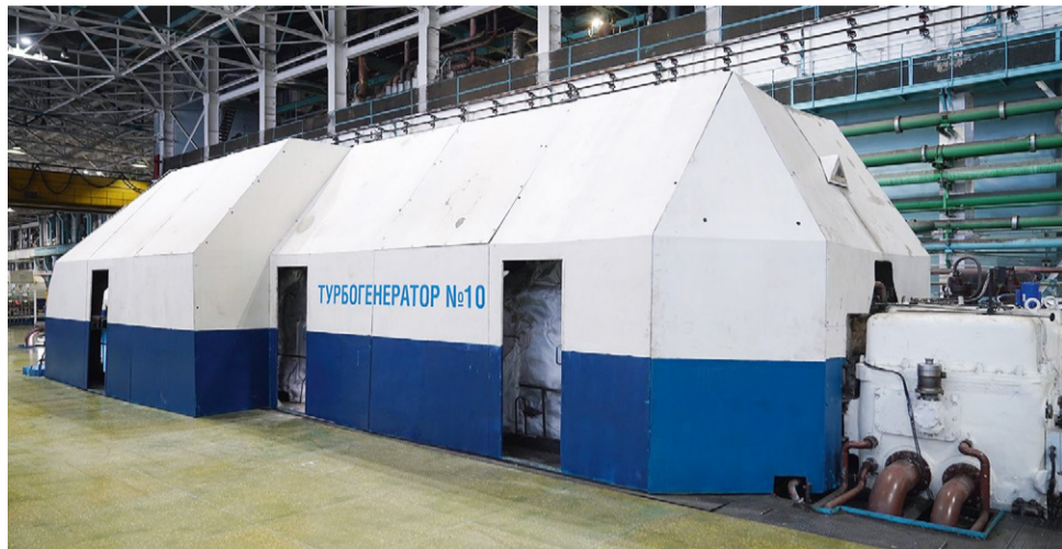
С вводом энергоблока № 10 в 2002 году электрическая мощность станции достигла 330 МВт
