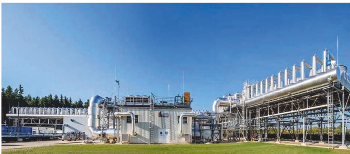
Рис. 35. ОЦР-установка Turboden с воздушным конденсатором на геотермальной станции
