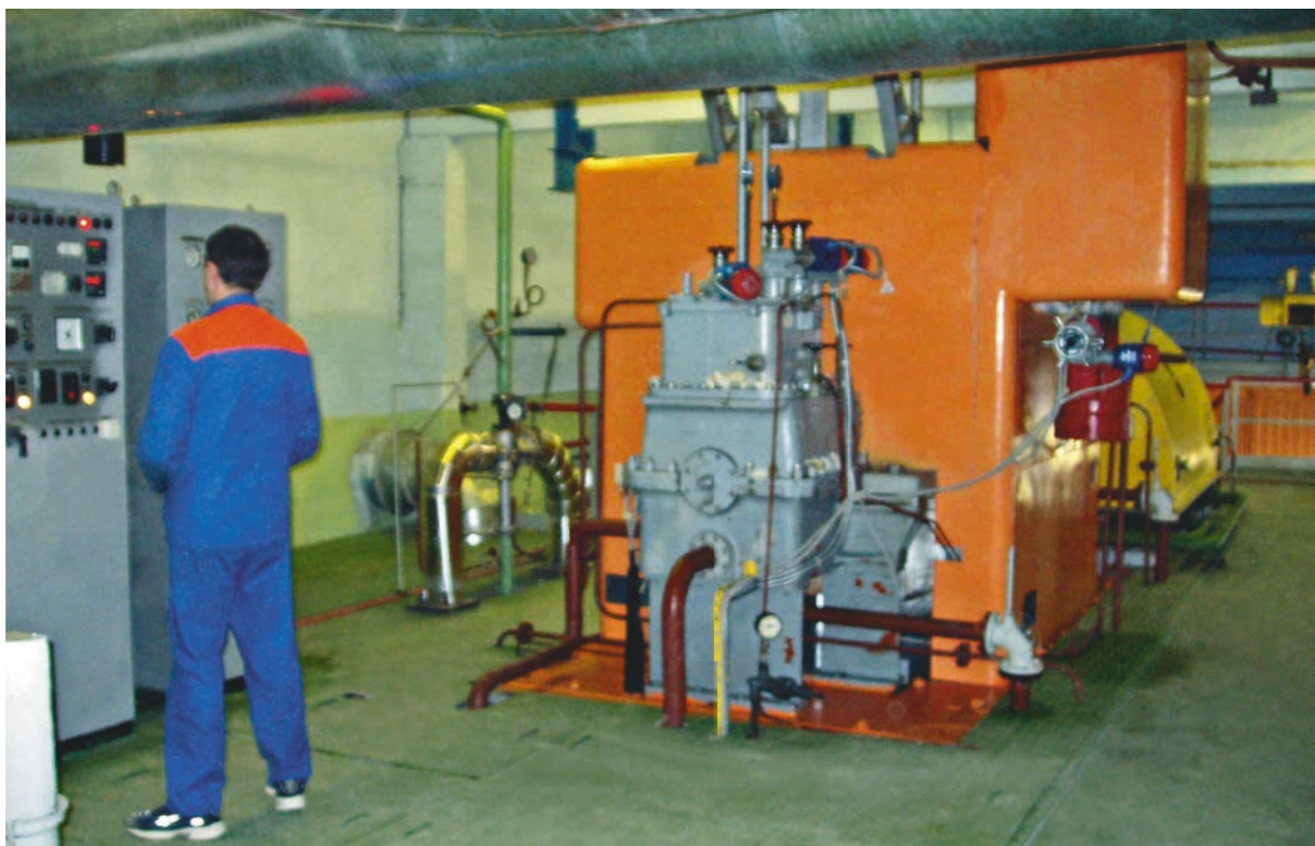
Рис. 3. Утилизационный энергокомплекс с турбиной Р-6-3,4/0,5 в тепловом блоке комбината (ОАО «Куйбышевазот») [4]
