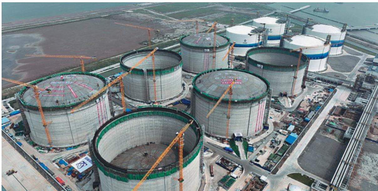
Рис. 14. Резервуары большой емкости для хранения СПГ ( https://www.chinadaily.com.cn/a/202209/08/WS63193e66a310fd2b29e76910.html )
