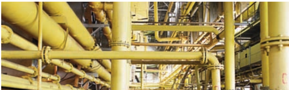
Оборудование химического цеха ТЭЦ-26, внутренний вид главного корпуса, машинный зал, паровая турбина Т-250 ТЭЦ-26
