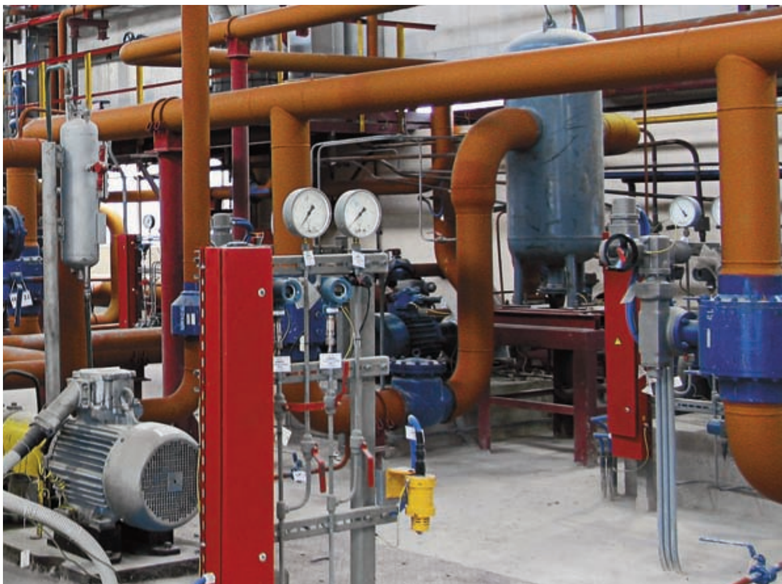
Общий вид насосной дизельного топлива. Дизельное топливо используется для ПГУ-450Т в качестве аварийного топлива
