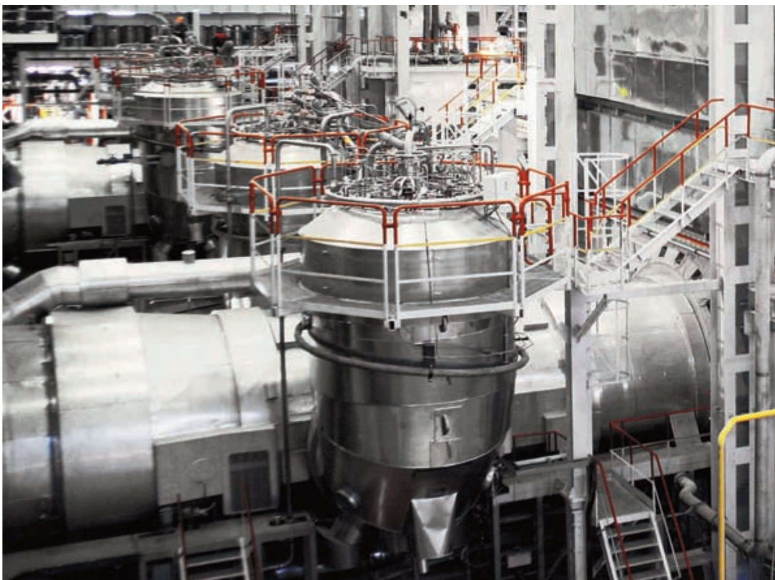
Внутренний вид главного корпуса энергоблока № 3 ПГУ-450Т на ТЭЦ-27, ноябрь 2007 года
